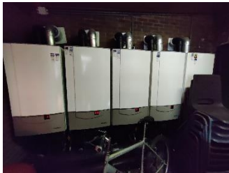
Figuur 2: Cv-ketels verwarming zwembadwater
