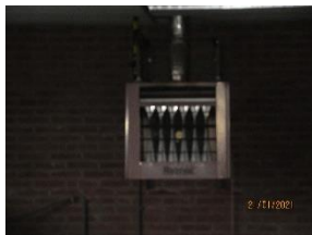
Figuur 5: Lucht verhitter zwembadinstallaties
