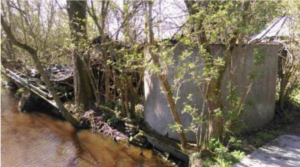
Afbeelding 2: Bestaande vervallen schuur en silo
