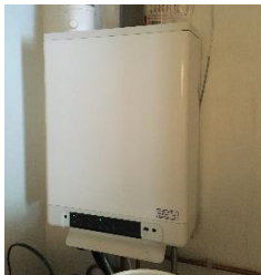
Figuur 2: Cv-ketel entreegebouw
